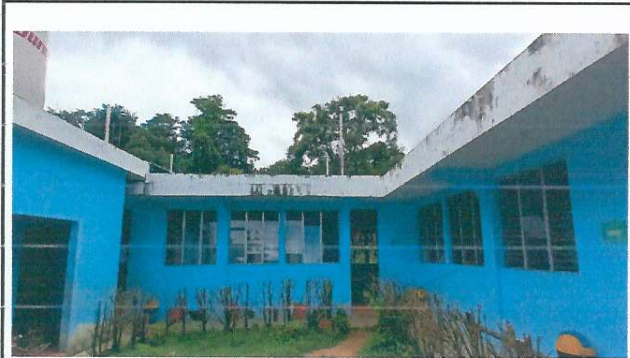
Foto 2: La humedad ha dañado la pintura exterior de la escuela
