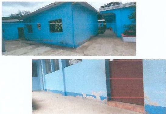
Foto 3: La humedad ha dañado los socalos y el repello de la base de los salones de clase.
